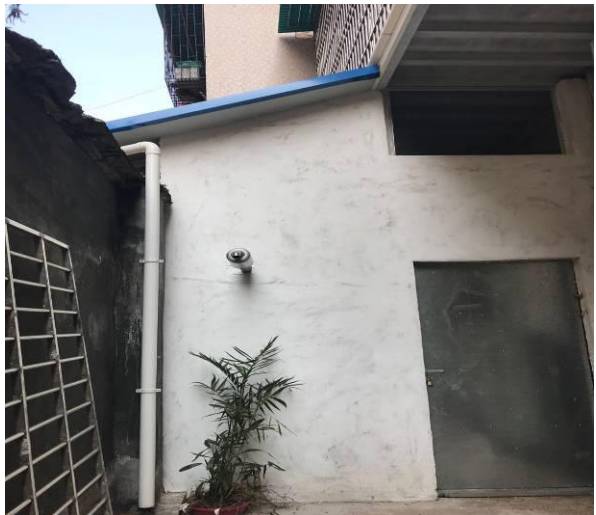
住院部备用发电机排气口
